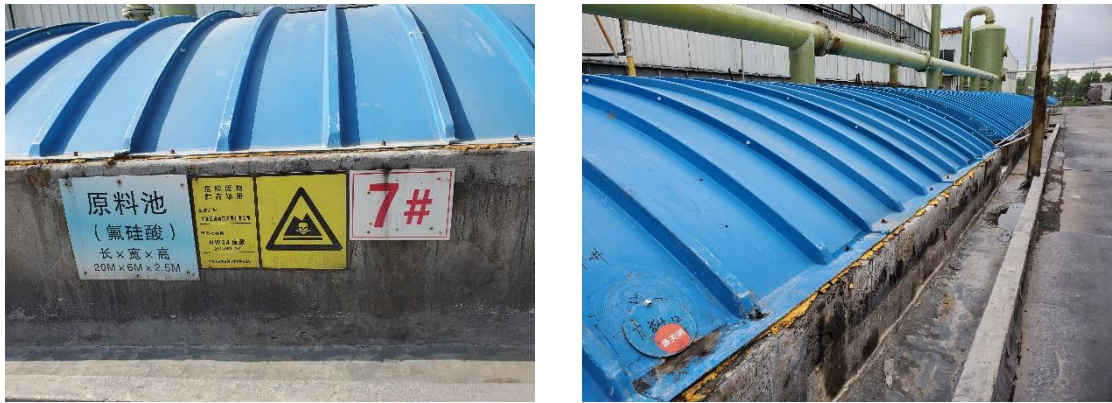
图 3-6 上清液暂存池区隐患排查情况
