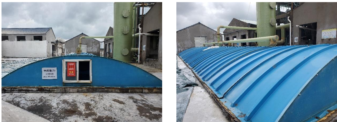
图 3-7 中间水池隐患排查情况
