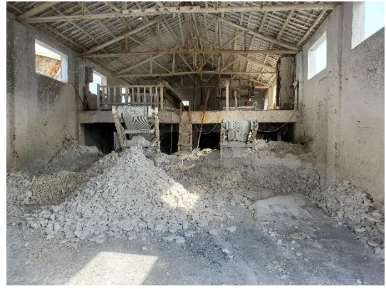
图 3-16 石灰处理间隐患排查情况
