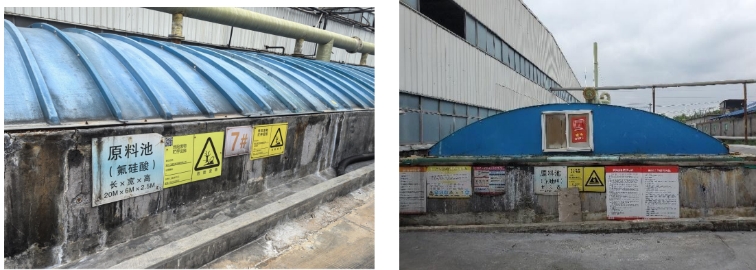
图 3-4 氟水池区隐患排查情况
