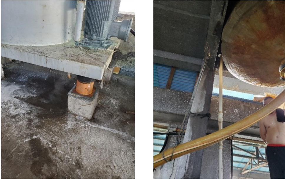
图 3-14 氟硅酸钠车间隐患处
