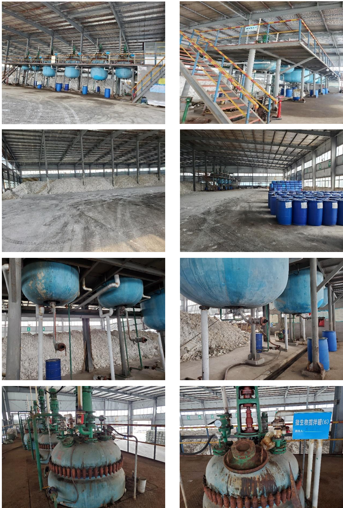
图 3-12 微生物车间隐患排查情况
