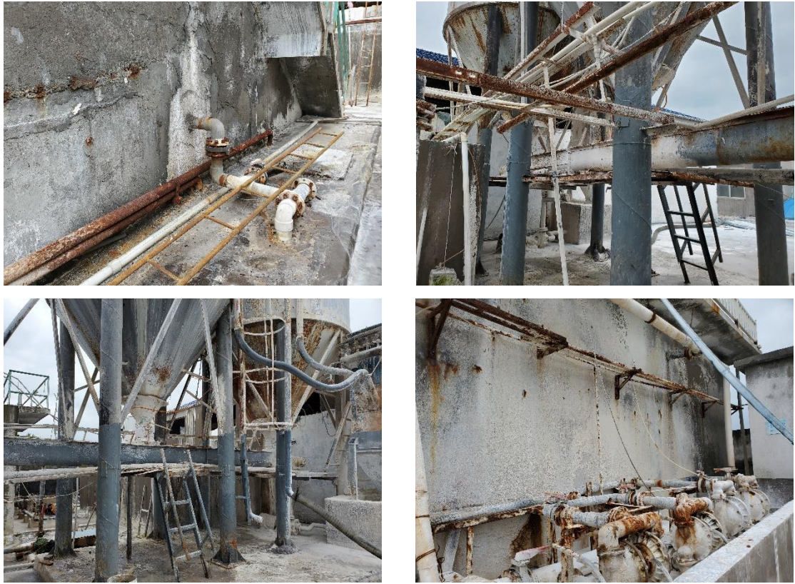
图 3-17 压滤间隐患排查情况
