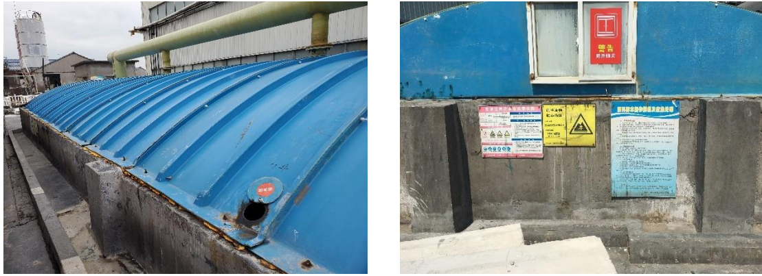
图 3-5 卤水池区隐患排查情况
