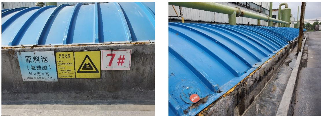
图 3-6 上清液暂存池区隐患排查情况
