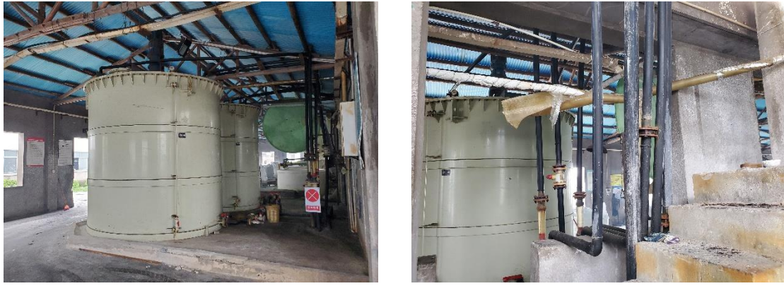
图 3-13 氟硅酸钠车间隐患排查情况
