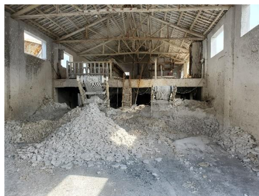
图 3-16 石灰处理间隐患排查情况
